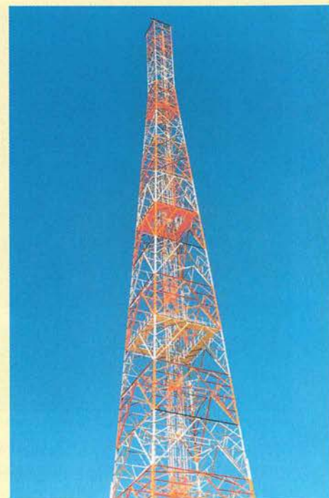
Torre 80 m disponível para locação em Goiânia
