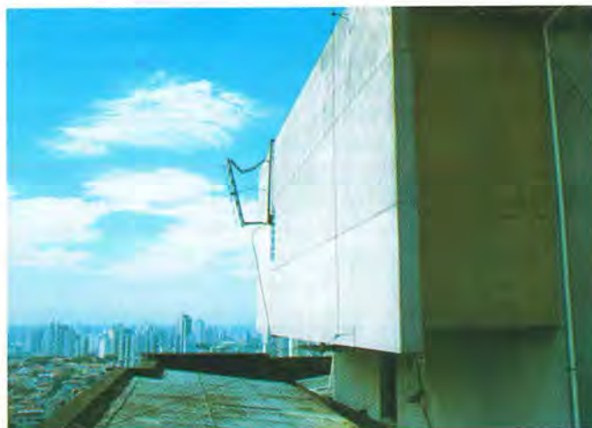
Antena de transmissão
