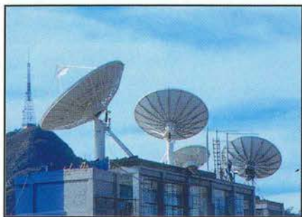
Sistema de recepção e transmissão de sinais.
