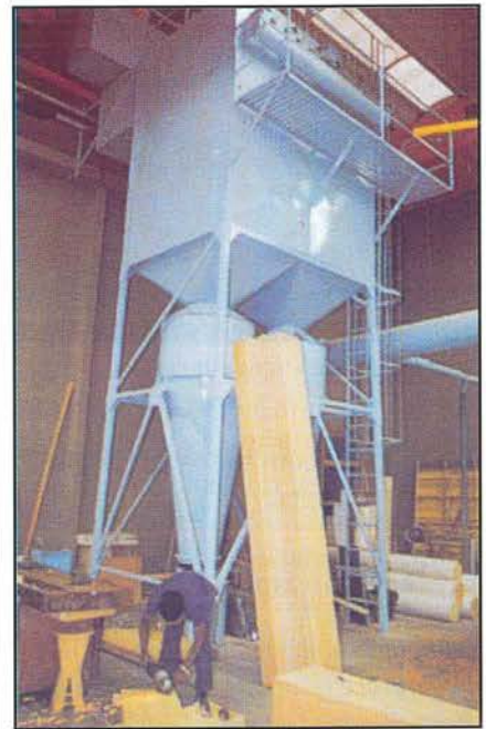
Sistema de exaustão de serragem do setor de marcenaria.
